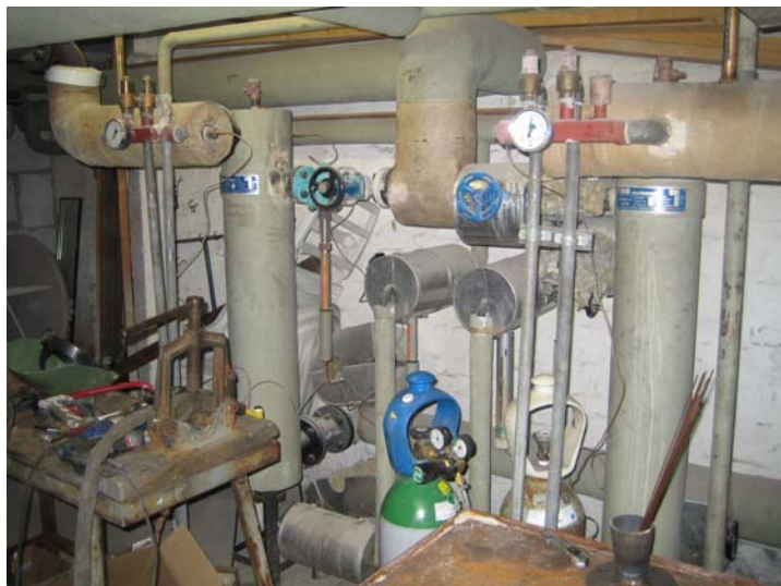
Det gamle anlæg med de runde dampvarmevekslere
